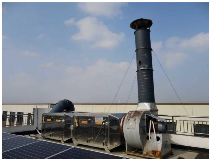
图 3-1 过滤棉+两级活性炭吸附装置
