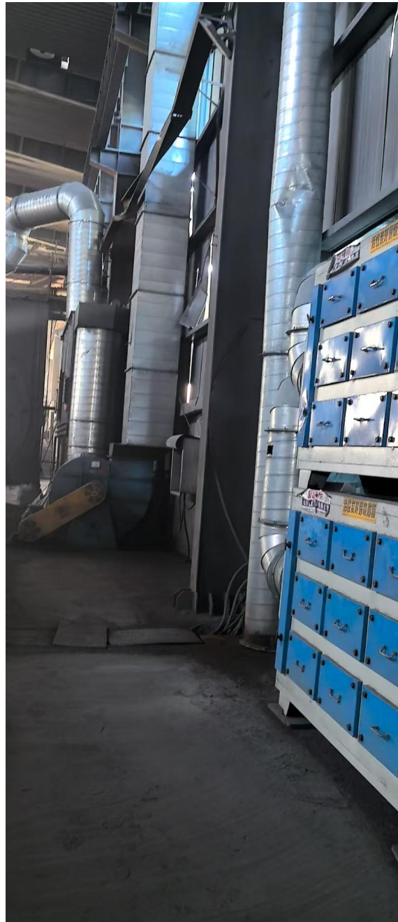
小管外喷废气处理装置
