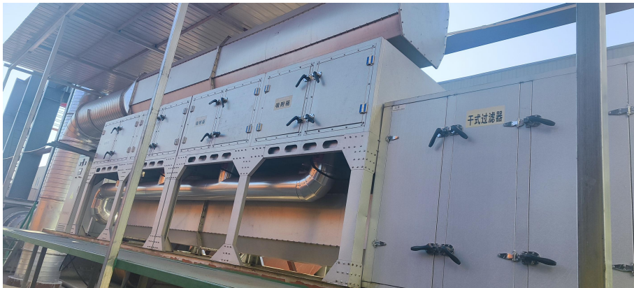
大管喷漆废气处理装置
