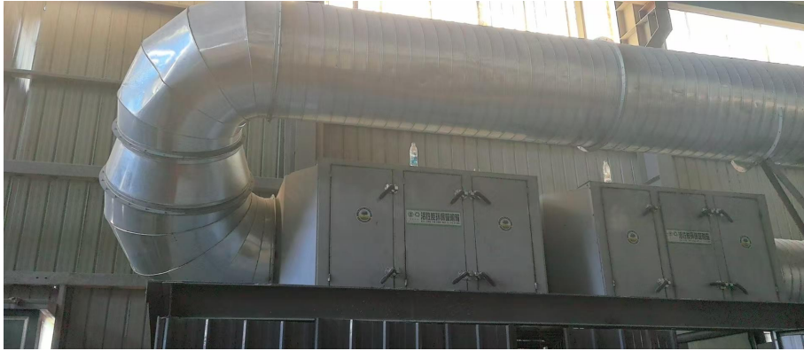
小管刷漆废气处理装置
