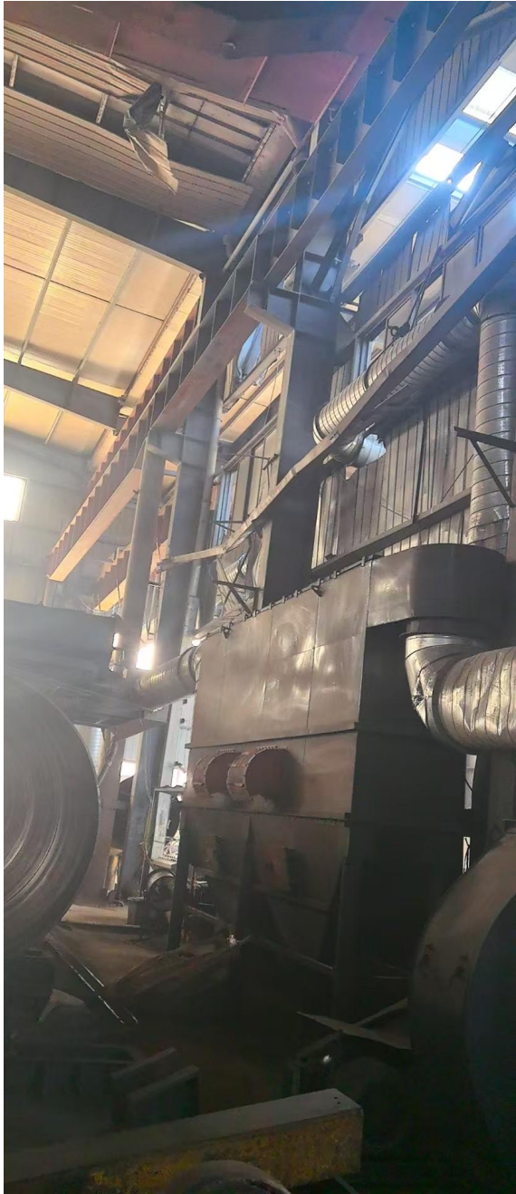
大管外抛除尘器
