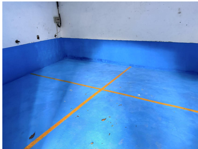
图 3-4 危废仓库内部照片
