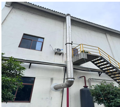
图 3-1 沼气锅炉废气排放口
