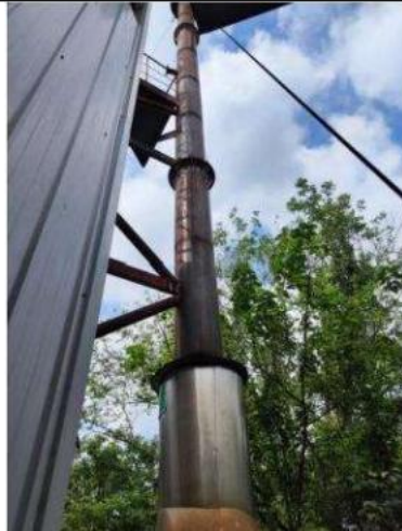
图 3-2 发电废气排放口
