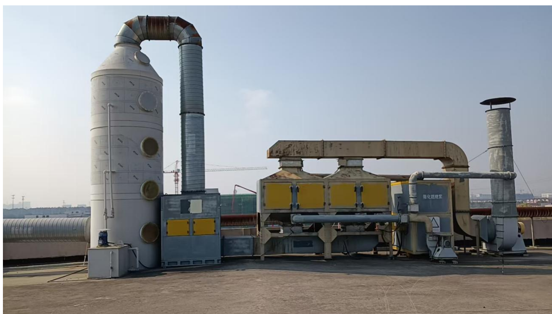
图 3-1 水喷淋+干式过滤+活性炭吸附+催化燃烧装置
