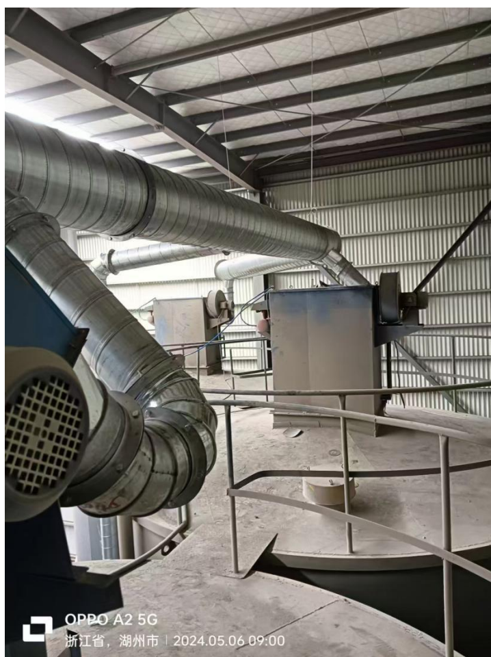
图 3-1 库顶脉冲布袋除尘器
