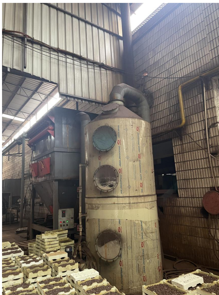
图 3-1 脉冲布袋除尘器+水喷淋
