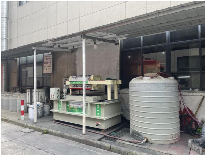
图 3-5 污水处理回用设备
