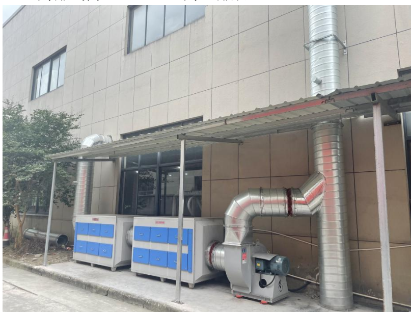
图 3-1 水印油墨废气处理装置
