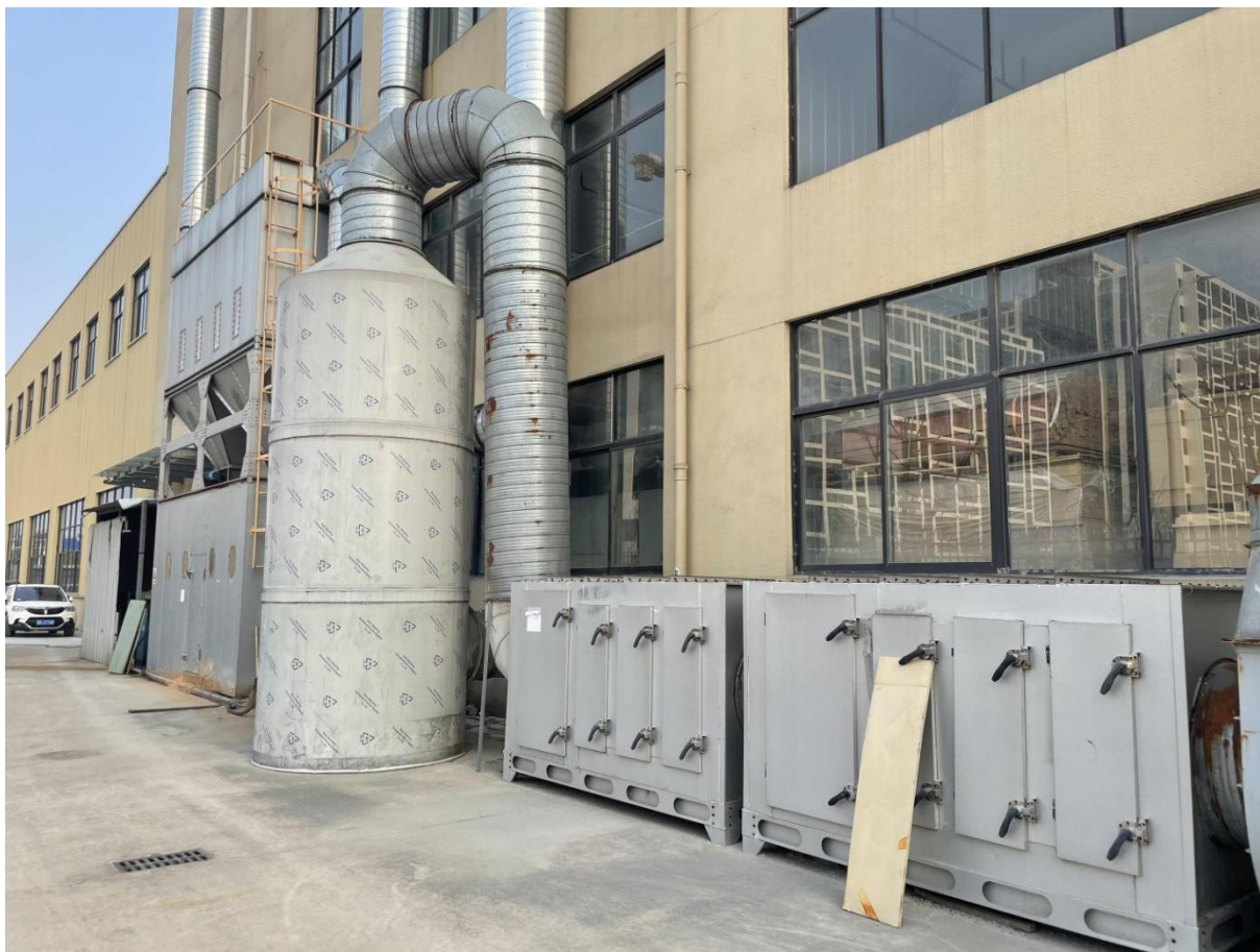
图 3-5 水喷淋+干式过滤+活性炭吸附装置
