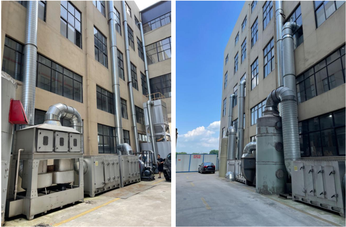
图 3-4 水喷淋+干式过滤+活性炭吸附装置
