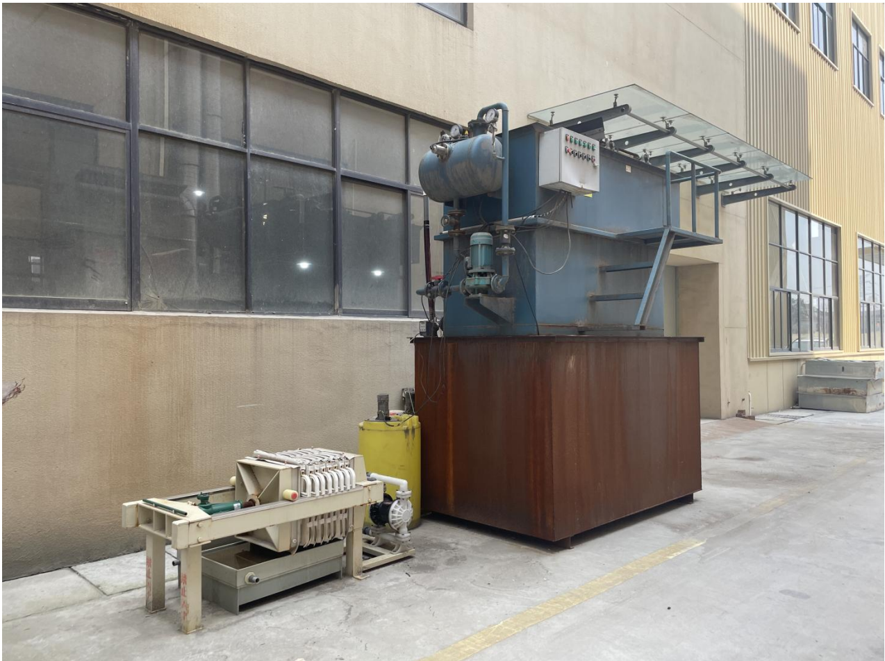
图 3-6 污水处理回用设备
